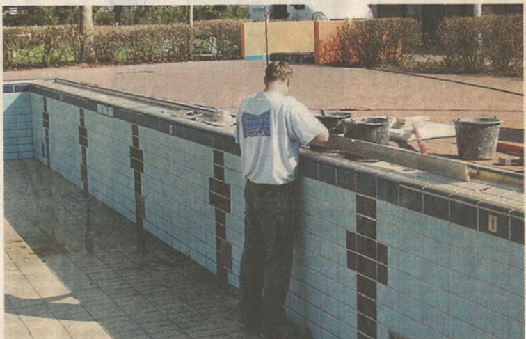
Kaputte Fliesen: Im Schwimmerbecken werden die Frostschäden beseitigt
